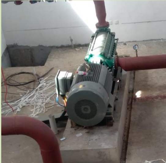
提灌工程水泵
